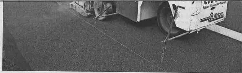
Rüttelstreifen, kleine Rechtecke, werden in den Standstreifen der A 24 eingefräst. Foto: Archiv
